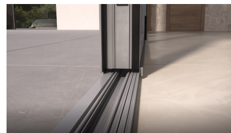
Seuil PMR à Rupture de pont thermique
